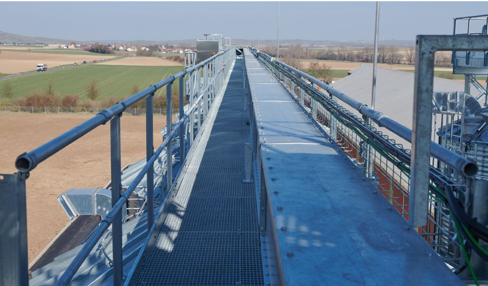
Vollflächige Laufsteganlage mit Trogkettenförderer; Länge: rund 60 m
