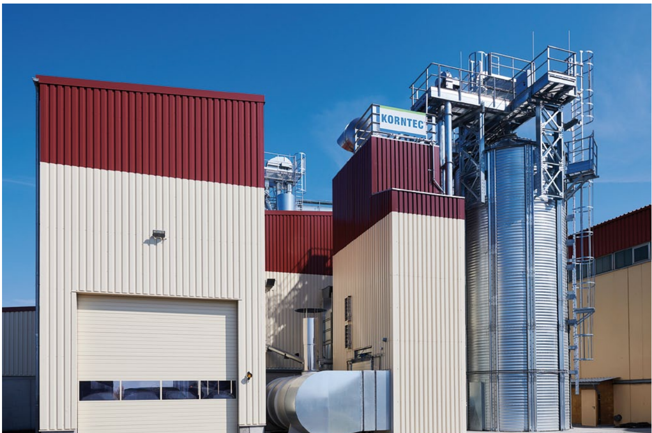
Annahmehalle, Trocknungs- und Siloanlage
